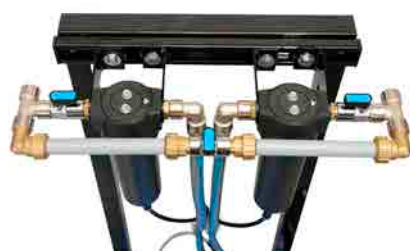
Detail obchozího potrubí
